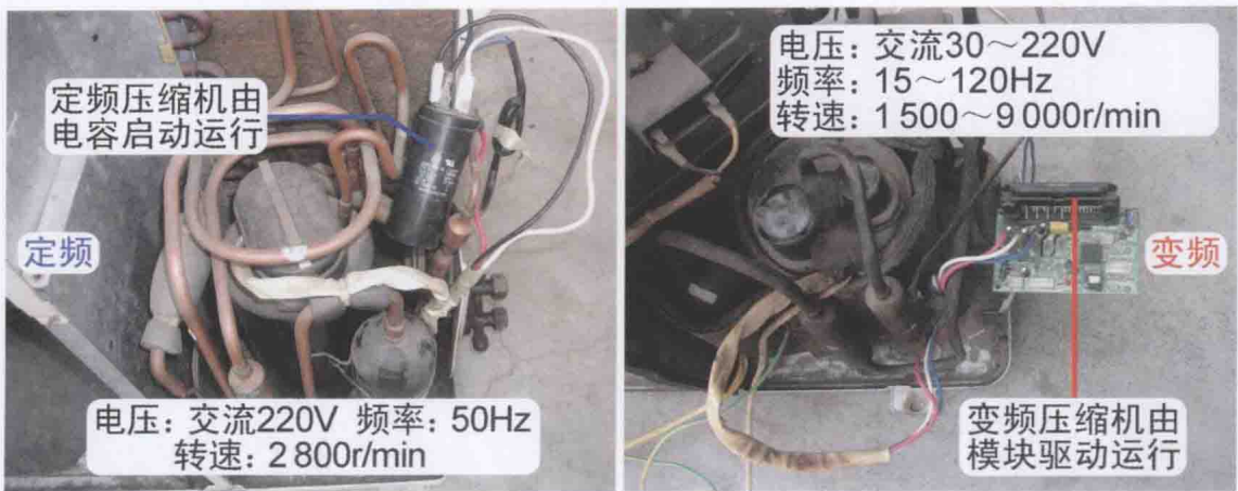
图1-13 室外机压缩机工作状态
