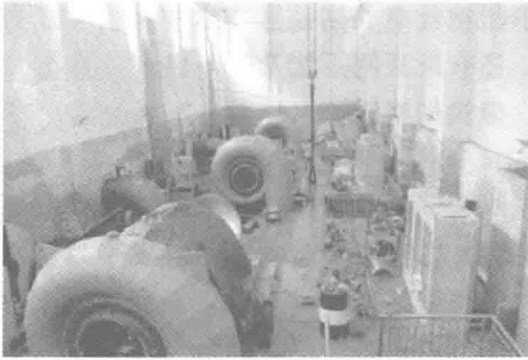
图 1-2 被洪水淹没的厂房
