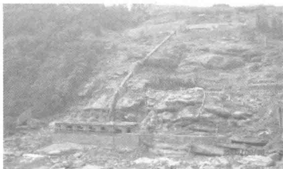
图1-6 双龙水电站前池垮塌
