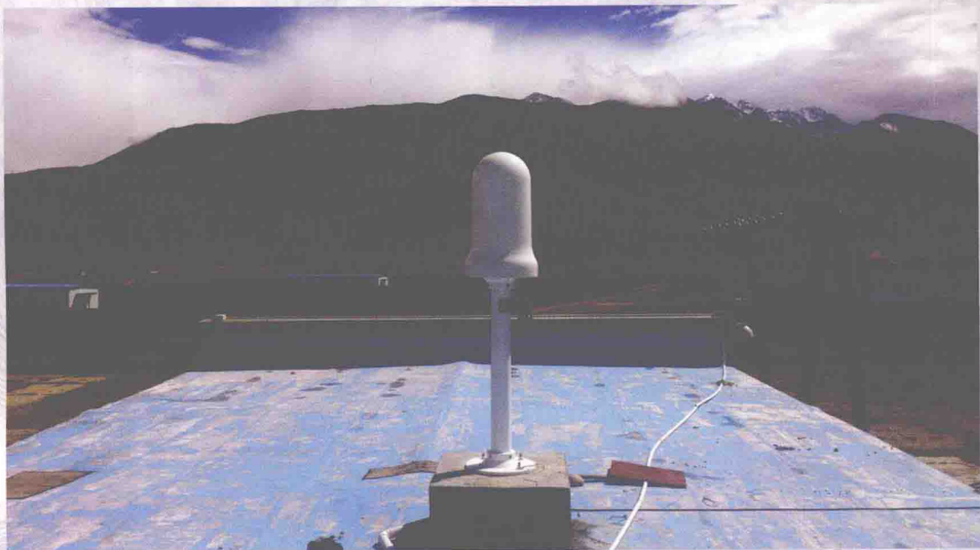
2014年11月14日，南瑞集团承建的西藏电网新一代雷电定位系统竣工验收。图为西藏电网羊八井雷电探测站的探测装置。
