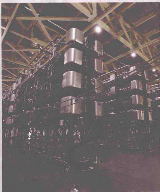
2014年7月4日，南瑞集团自主研发的世界首个五端柔性直流输电系统在浙江舟山投入运行。图为柔性直流换流阀。
