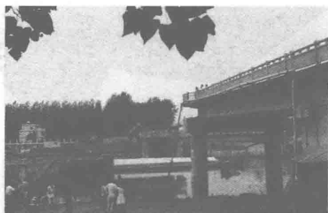
i)通榆河桥发生坍塌
