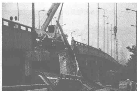
k)钱塘江第三大桥引桥桥面出现塌落
