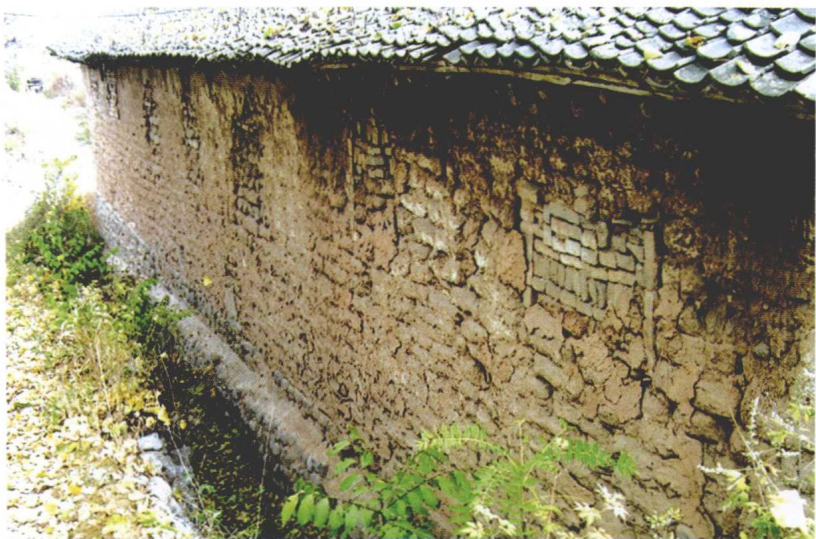
日军在董封村村民墙上挖射击孔,使村民房屋受到严重损坏
