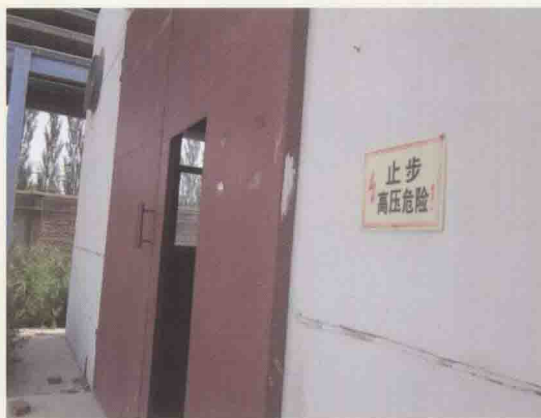
● 高压配电室未上锁
