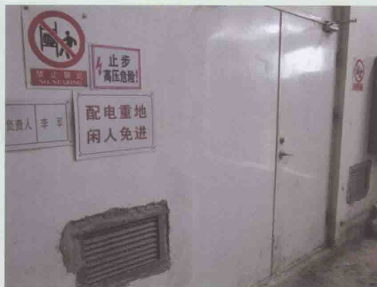
● 高压配电室警示标识
