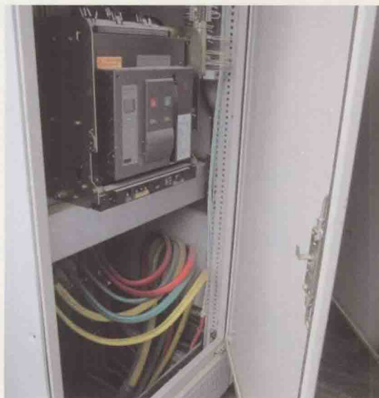
● 开关柜未关闭锁紧
