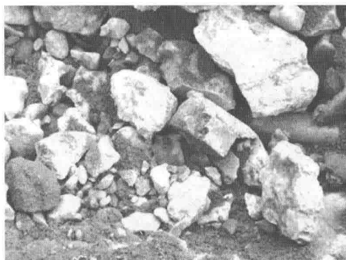
(a) 回填土中垃圾过多
