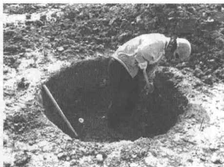
(b) 孔壁坍塌
