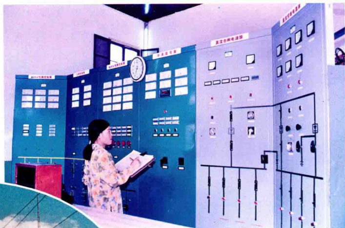
35 千伏岭口变电所主控室
