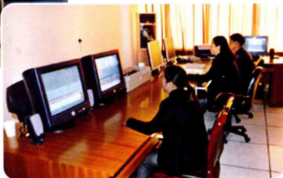
磐安县供电局变电运行监控站
