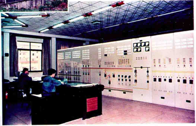
110 千伏磐安变电所主控室
