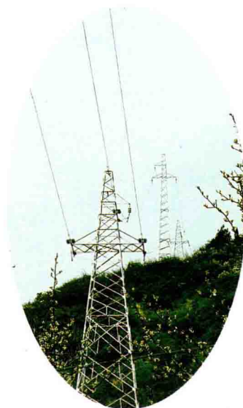
35 千伏输电线路
