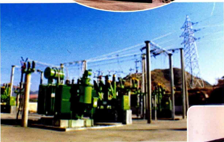
35 千伏仁川变电所
