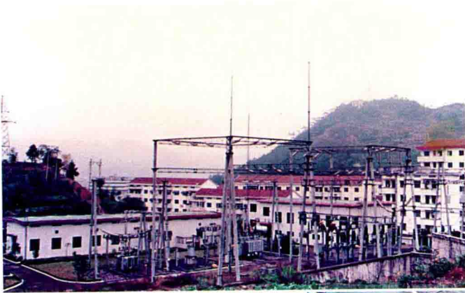
110 千伏磐安变电所
