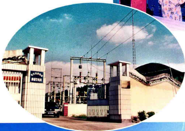
35 千伏尚湖变电所
