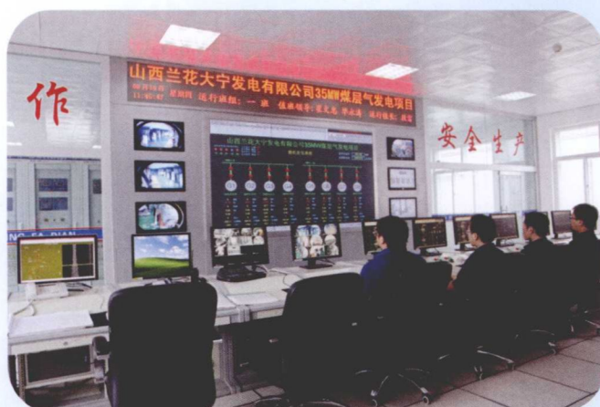
瓦斯发电主控室
