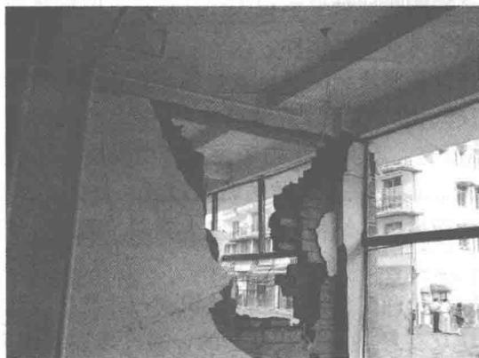
图 1.2-1 墙体局部砌块脱落
