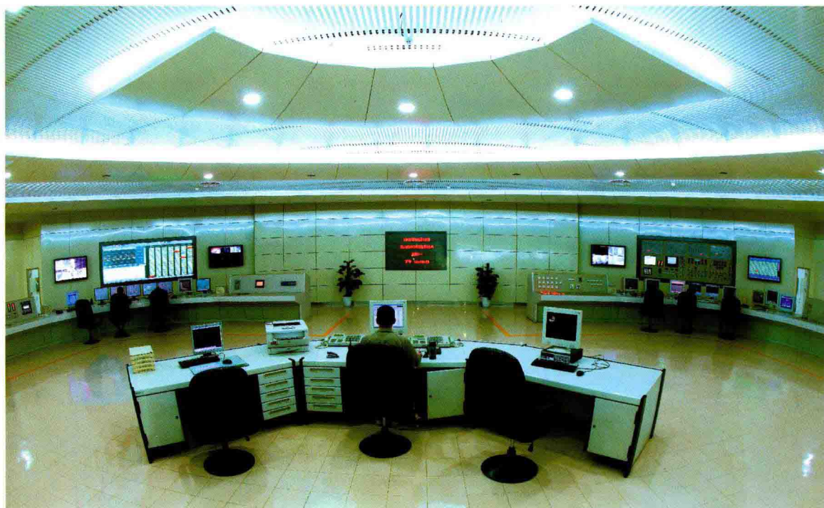
一期 2×300MW 机组集控室
