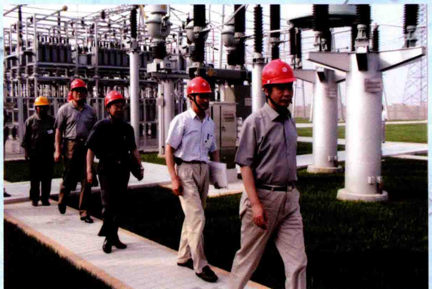
2001年6月15日，国家电力公司华东公司总经理邵世伟等视察500千伏石牌变电站
