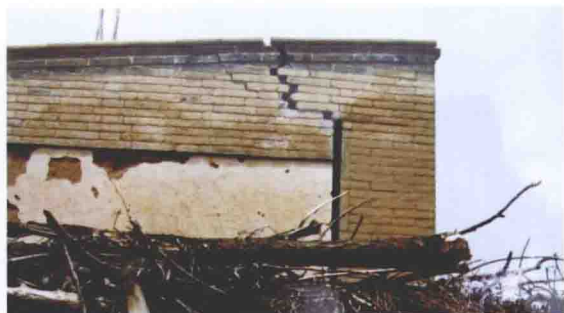
1987年灵武5.5级地震，墙体裂缝
