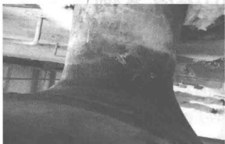
(a) 东侧焊口开裂形貌
